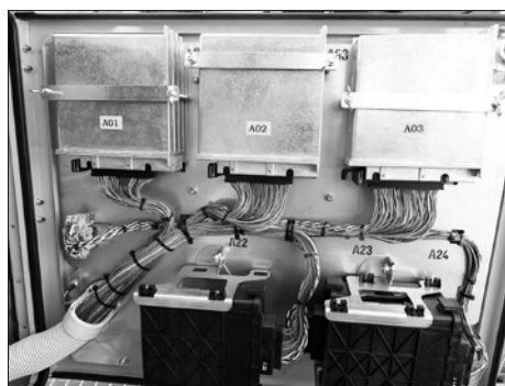
Deckel des Zentralelektrikschrank
