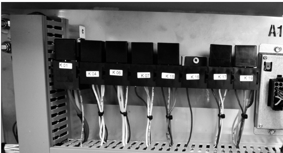
Relais im Schaltschrank der Zentralelektrik
