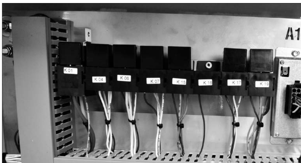
Relais im Schaltschrank der Zentralelektrik
