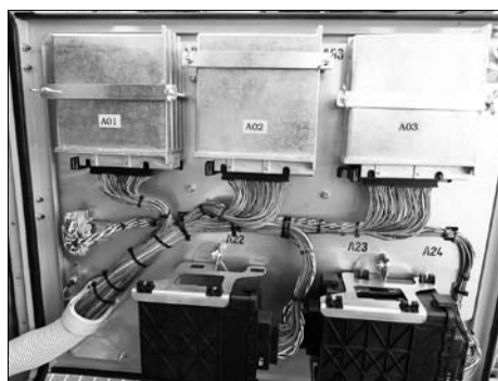
Deckel des Zentralelektrikschrank
