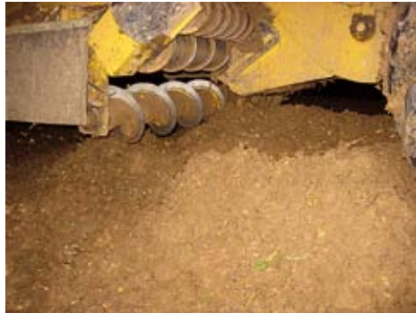
Hier ist die maximale Höhe des Erdhaufens erreicht. Die Maschine sollte jetzt versetzt werden.
