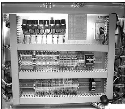
Schaltschrank der Zentralelektrik
