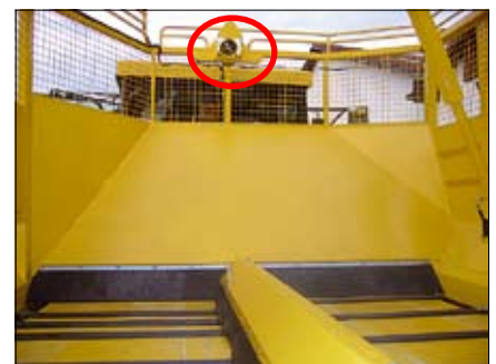
Ultraschallsensor im Bunker vorne.
